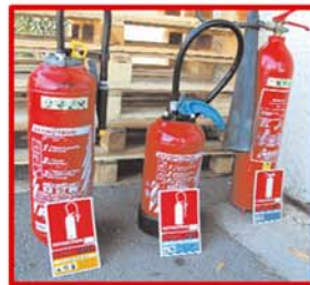
LA PRÉVENTION INCENDIE
